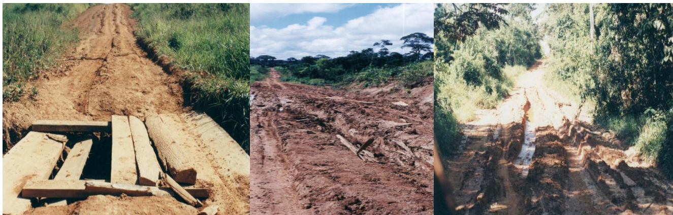
Fotos 3,4 y 5. Caminos en mal estado de difícil transitabilidad
